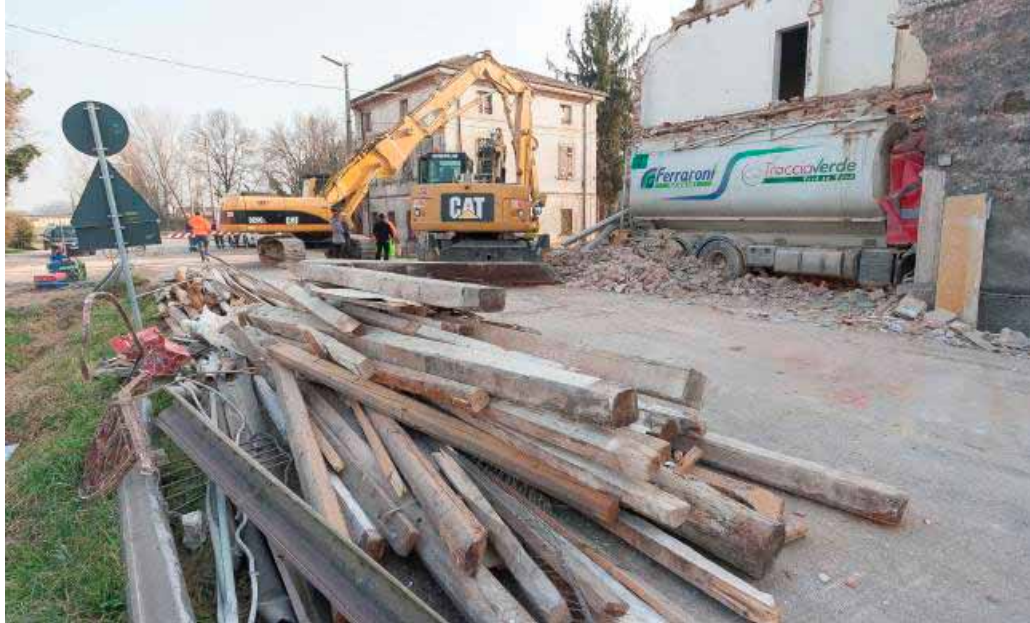
Il cumulo di macerie lungo via Casalmaggiore, che resta chiusa al traffico (fotoservizio Studio B12)
